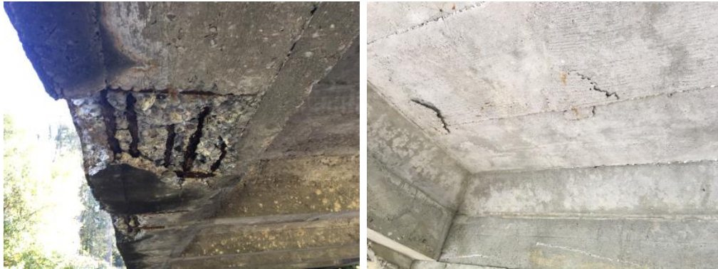
Abb. 112 Abplatzungen an der Untersicht einer 1937 erstellten Brücke. Links: Abplatzungen im Eckbereich der Wetter abgewandten Ostseite der Brücke. Rechts: Abplatzungen im mittleren Teil der Brückenplatte.
